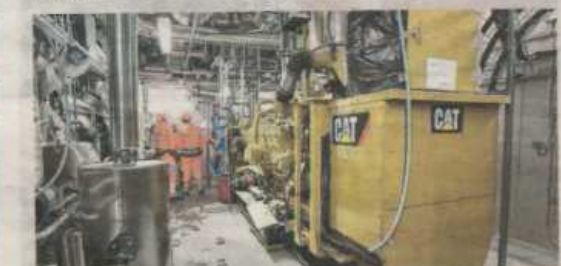
Un moteur V16 (à droite) alimenté au gaz.
