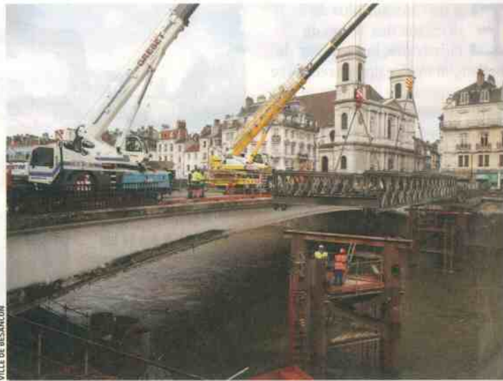
Le pont Battant, en béton précontraint, sera découpé à partir de la mi-juin.
