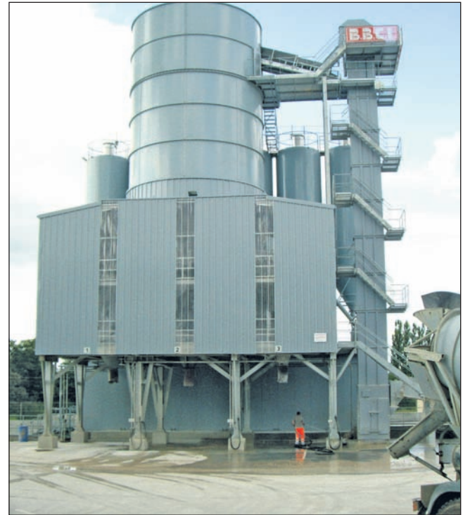
Avec Holcim et S.A.T.M., le groupe Bonnefoy a fourni 420 000 m 3 de béton dont une partie provenait de la centrale à béton de Franois.
